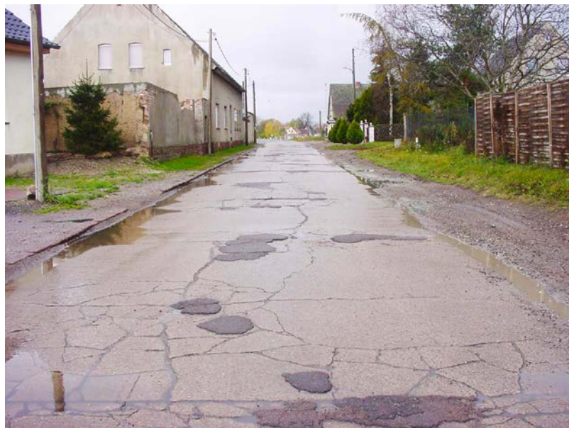
Bild 65 Wohnstraße mit schadhafter Betonbefestigung / © MIL
