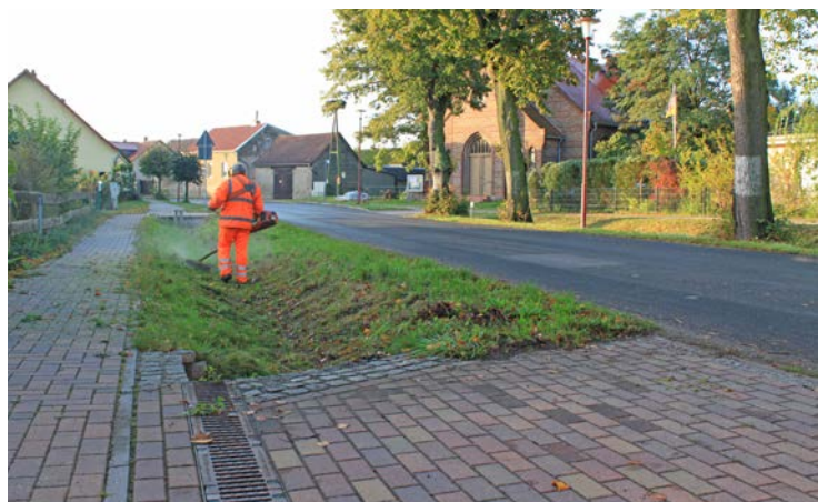
Bild 54 Pflege der Entwässerungsanlagen / © MIL
