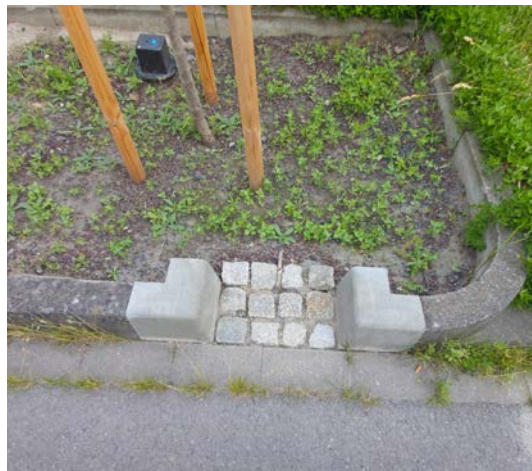
Bild 27 Beet und Baumentwässerung (Hoppegarten) / © MIL
